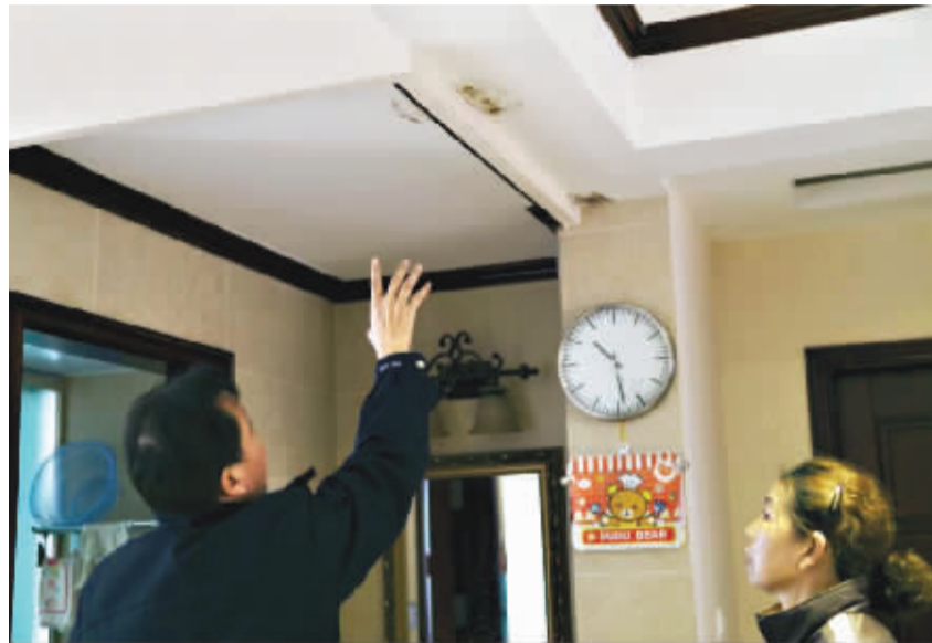
方学胜查看武铁佳苑住户家中漏水情况 罗维舟 摄
