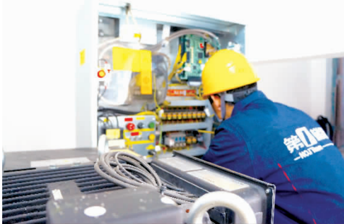
芝友机电维保人员在进行电梯控制柜检查
