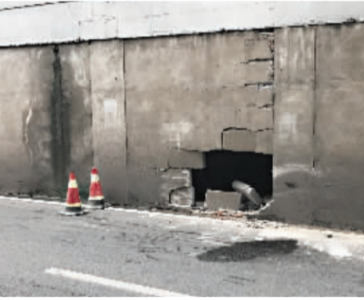
江汉桥汉口下桥处墙面被撞出一个洞 记者姚传龙 摄
