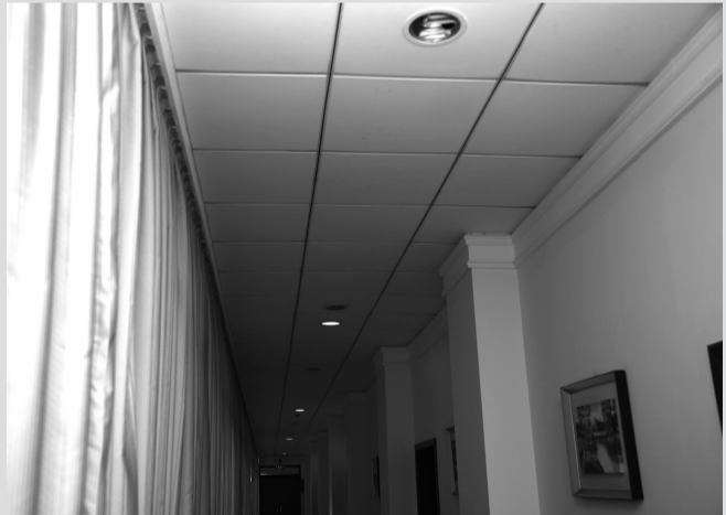
湖北省邮电学校3号招待所未安装喷淋系统
