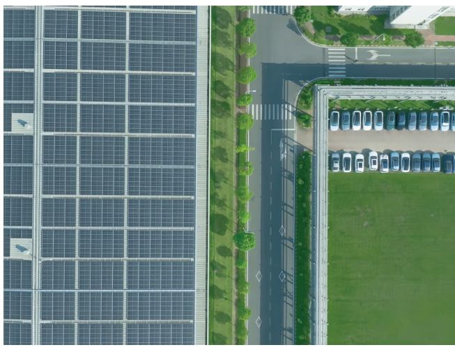
岚图汽车工厂,一块块光伏面板为智能工厂增添“绿色实力”。
