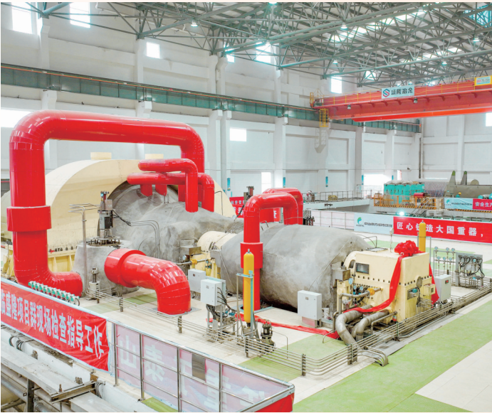
中冶南方打造的全球首套超临界煤气发电机组。
