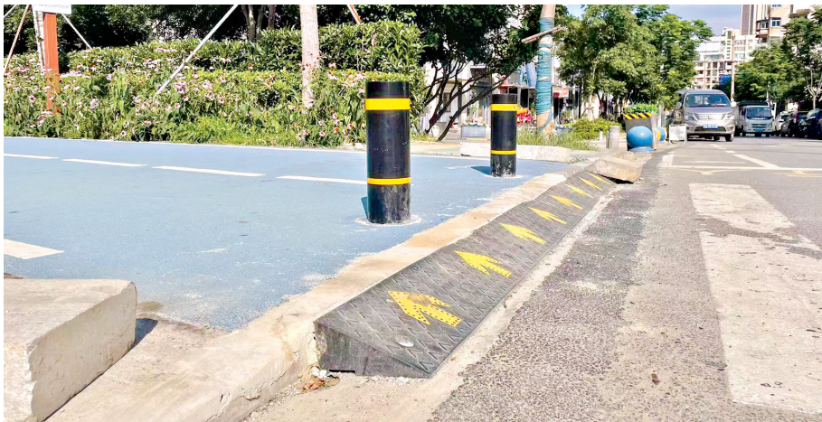
6月13日,记者再次探访时,一处绿道路口已铺设斜坡垫。长江日报记者尹勤兵 摄
