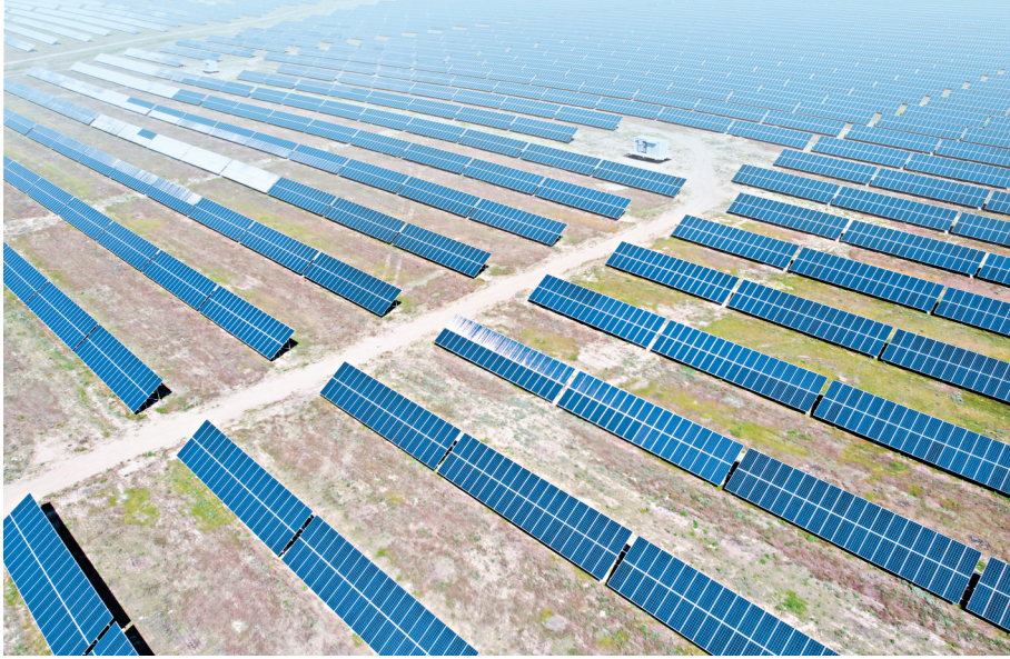
这是2023年5月4日在哈萨克斯坦阿拉木图州拍摄的卡普恰盖100兆瓦光伏电站的太阳能电池板(无人机照片)。
