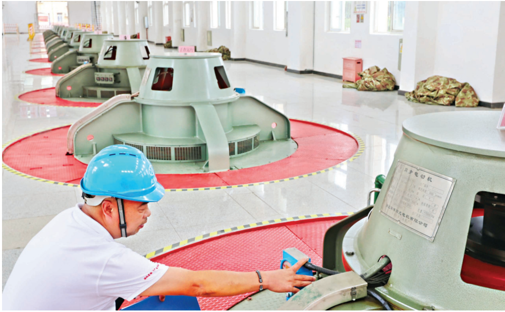
汤逊湖泵站15台机组全部开启满负荷运行,工作人员正在检查机组运行情况。
