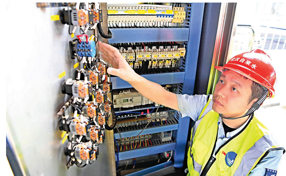
蒋锐在琴断口水厂制水车间巡检滤池、排泥行车、控制箱等设备。 长江日报记者高勇 摄
