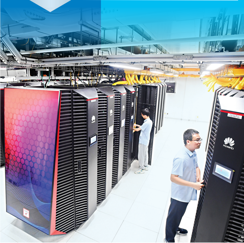
武汉超算中心机房内,工程师正在巡检服务器机房并进行调试。
