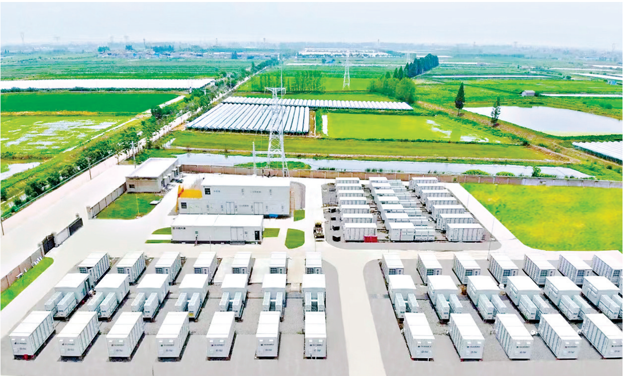
大唐湖北储能电站项目现场,63个长方形箱体设备整齐排列,项目如同一套庞大且结构严密的巨型电池组。
