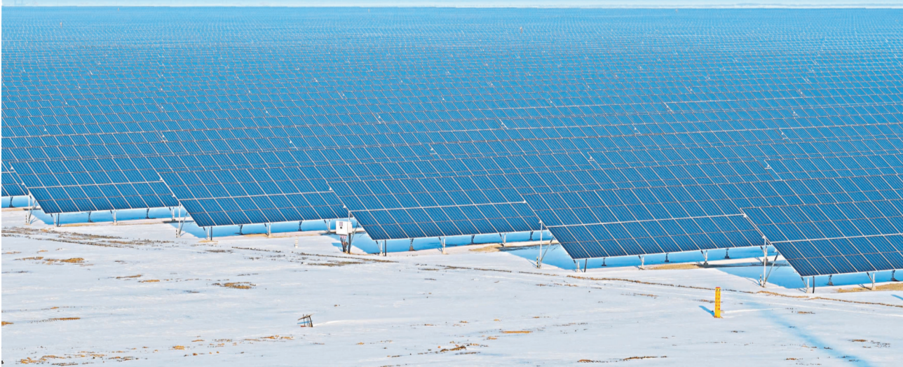
2023年12月20日在木垒县拍摄的华电新能源木垒250兆瓦光伏项目。
