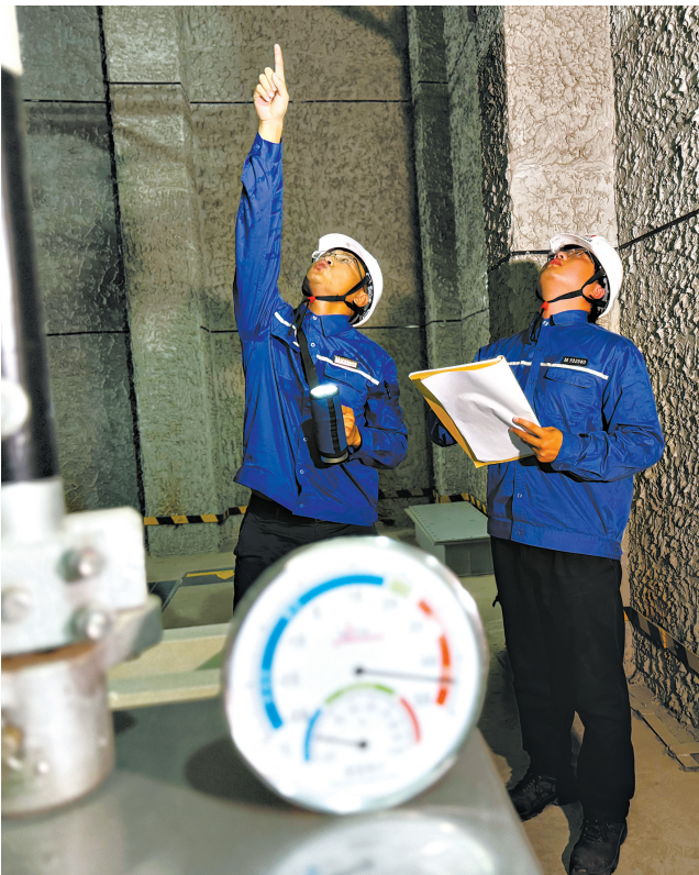
董锐(左)和同事肖欣宇巡查徐家棚主变电所核心区域控制室。
