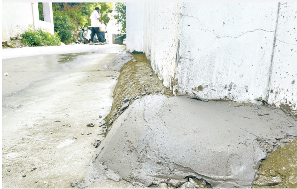
8月19日,施工人员直接在水管上抹了混凝土。 长江日报记者尹勤兵 摄
