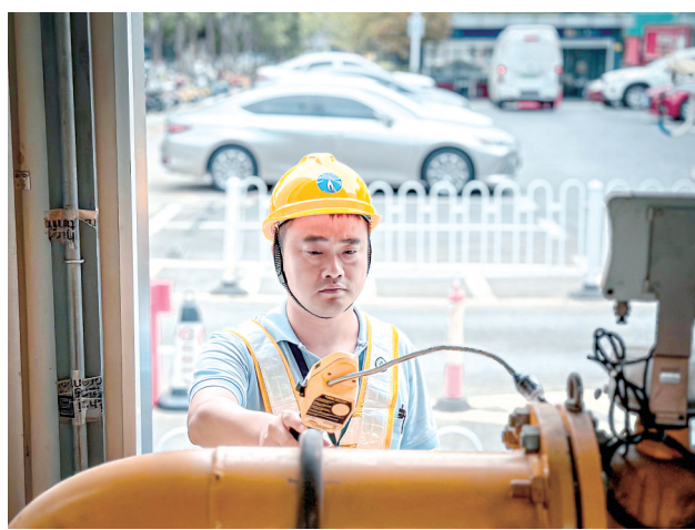
市燃气集团工作人员正在巡查燃气设备。
