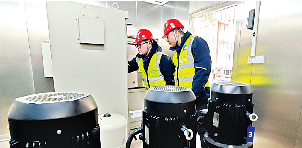
泵房是杨兴(左)待得最多的地方，图为他在设备间发现问题、解决问题。 长江日报记者何晓刚 摄
