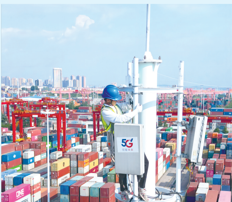
武汉电信助力阳逻港“智慧港口”转型升级。
