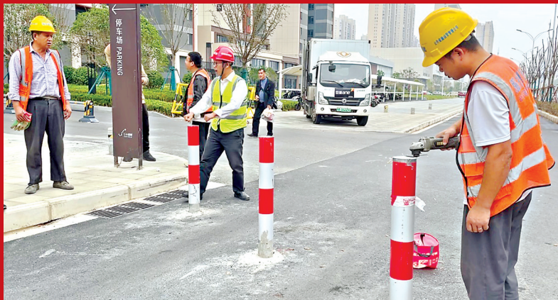
金山大道旁、东西湖万达广场对面的一处阻车桩,宽度仅为1米。交管部门组织安装警示柱。
