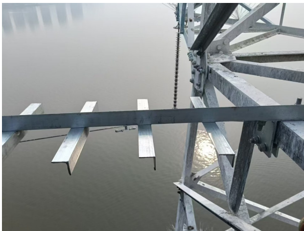
安装在输电铁塔上的栖鸟架是一个长约1米的金属结构框架。
