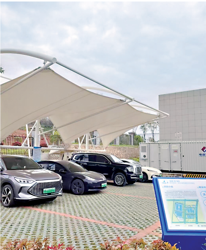
武汉铁塔公司门口的储能设施能在没有光照时,继续为厂区供电。 长江日报记者郝天娇 摄
