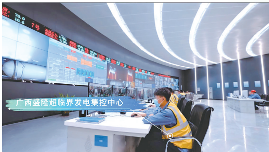
广西盛隆冶金超临界煤气发电集控中心。
