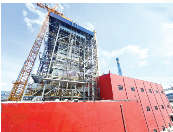
广东中南钢铁煤气高效发电三期135MW项目。
