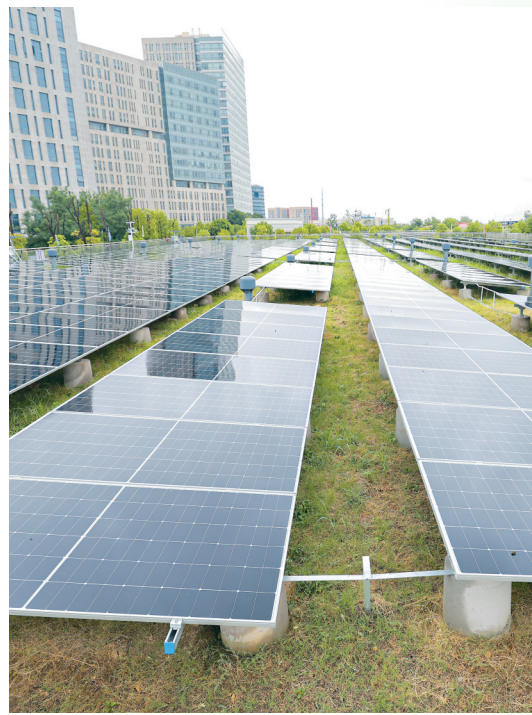
高新六路转压站光伏项目。
