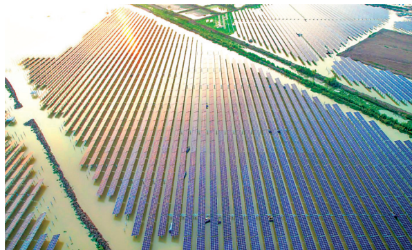
华润赤壁日曜渔光互补光伏发电项目。
