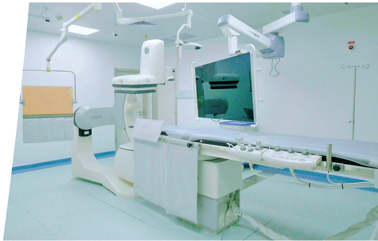
新大楼配备了DSA、直线加速器等一系列高精尖大型设备。
