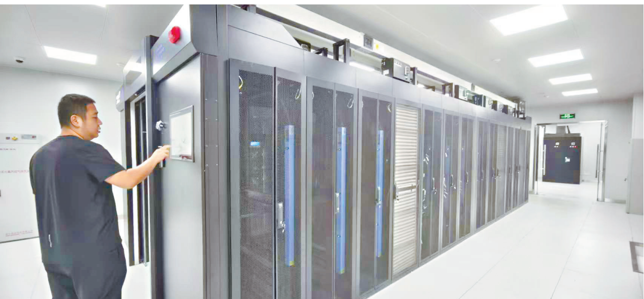
中国电子云武汉可信智算中心内,工程师正在巡控服务器机房并进行调试。
