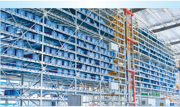
九州通智能物流中心穿梭车库。
