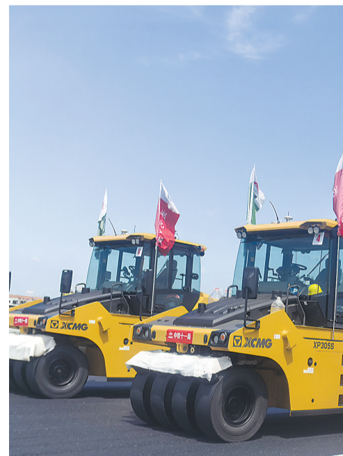
武汉新港高速公路无人摊铺现场。长江日报记者汪文汉 摄
