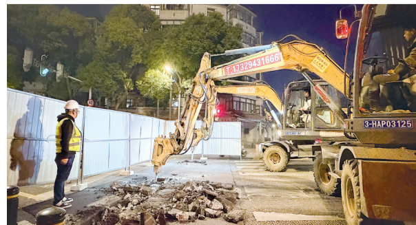
洪山路片区通信管道改造与架空线入地工程，将跨路“飞线”清零、废弃线缆杆清除。
