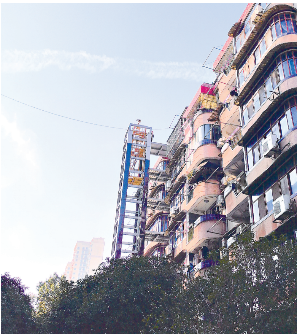
开屏里社区明珠小区加装的电梯。
