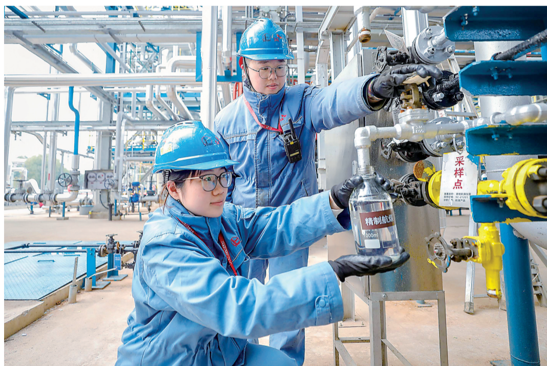
中韩石化年产120万吨航煤加氢装置日前投产。
