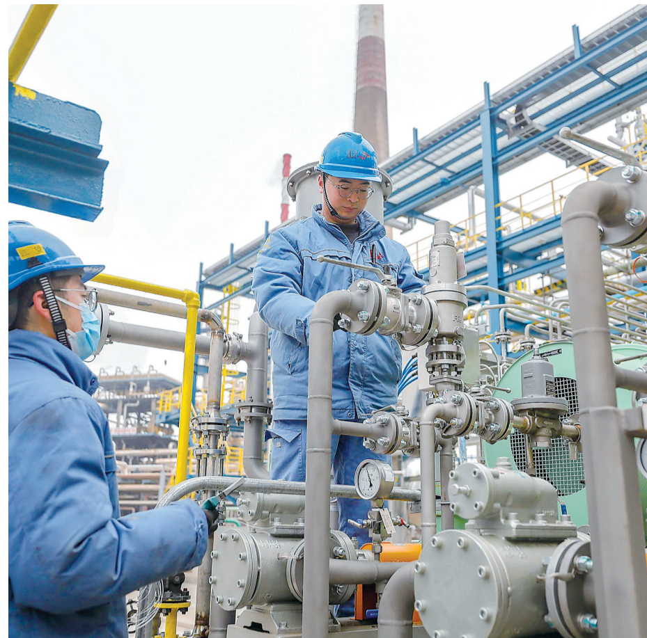
中韩石化年产120万吨航煤加氢装置。
