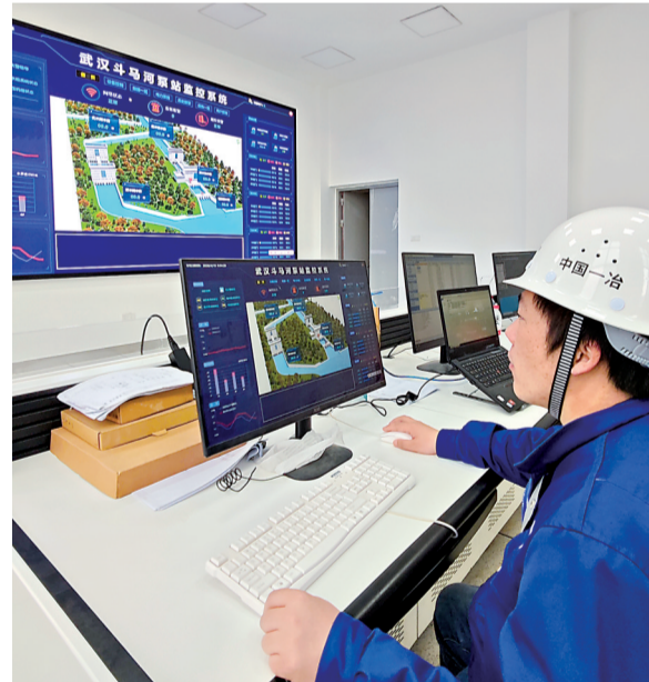
斗马河泵站抽排设备已接入智慧化管理平台。 长江日报记者宋磊 摄
