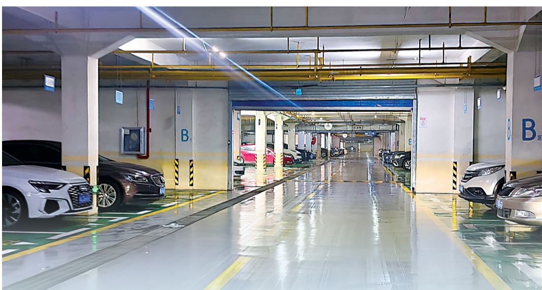
白沙洲彩虹郡小区地下车库返潮地面湿滑。
