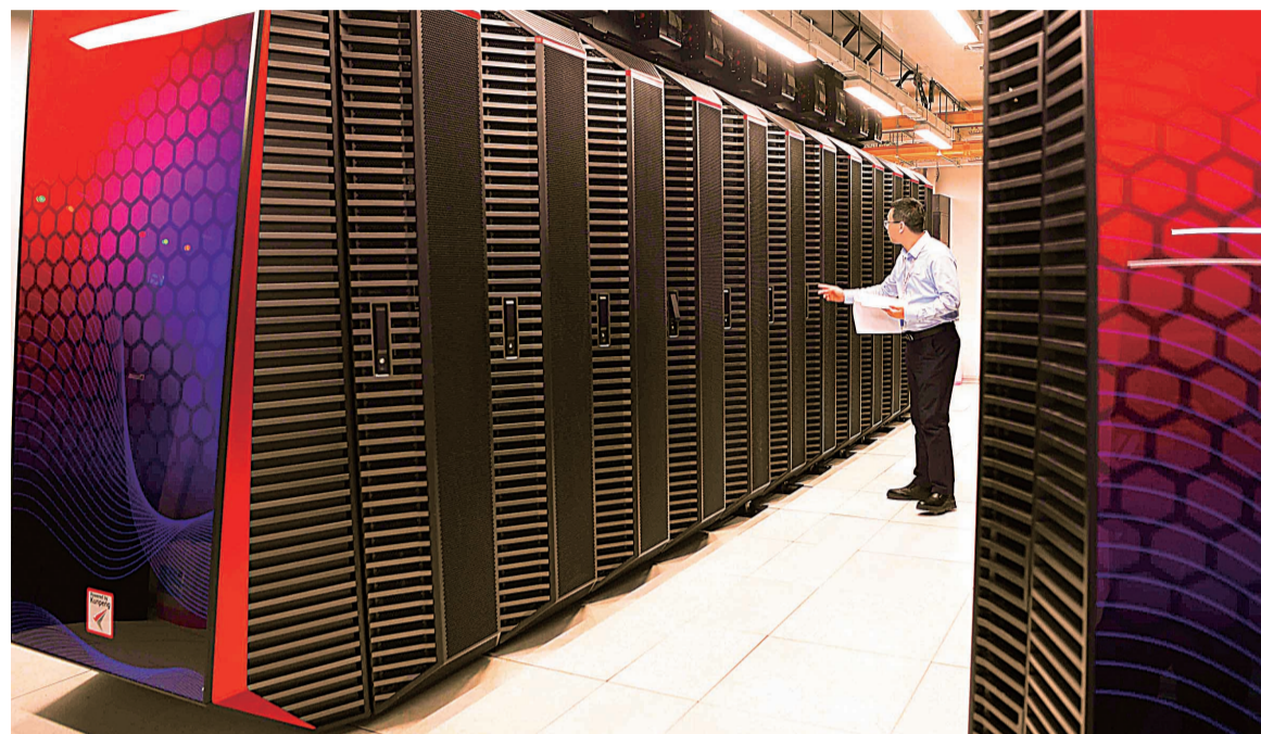
武汉超算中心机房。
