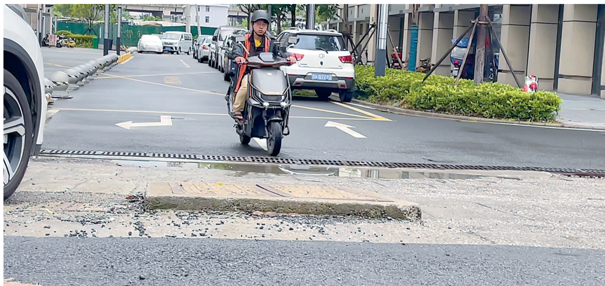
小区和市政道路衔接部分约60平方米未刷黑,“绊人井盖”影响居民出行。
