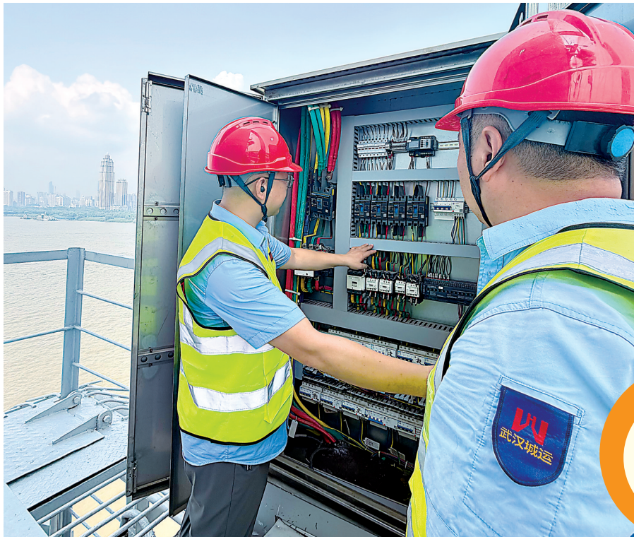
运维队员检查配电系统。 长江日报记者袁璇 摄
