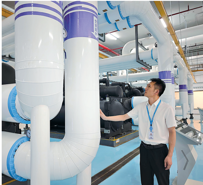
中建科技产业园综合能源站内，廖友飞正在检查设备运行情况。 长江日报记者宋磊 摄
