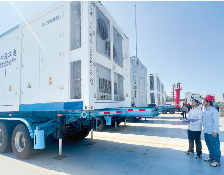
武汉新港空港综保区阳逻港园区华电船舶充换电站,船舶用集装箱式电池在充电。
